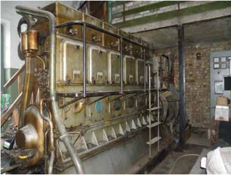
Čekoslovakiškas 1955 m. „Škodos“ dyzelinis variklis ir elektros generatorius. Telšių elektrinė (Antano Eičo nuotr., 2010 m.)
