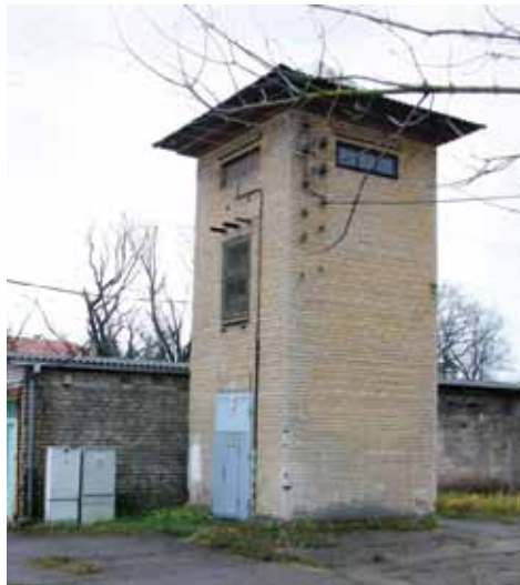
80-metė transformatorinė pastotė Petrašiūnuose, 2010-11-11
